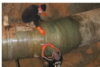
4. พันไฟเบอร์กลาส เสร็จแล้วทาเรซินที่ละชั้น จนถึงระดับตามมาตรฐานของผู้ผลิต
